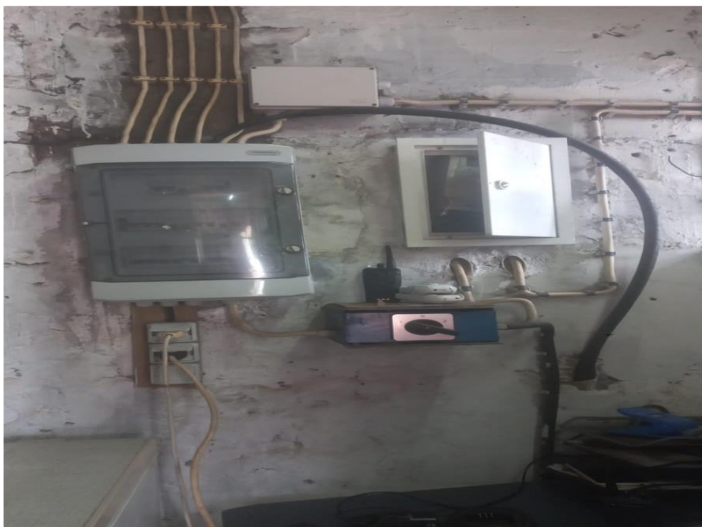
Cablagem Nova directa do PT para alimentação de bancadas e boxes
