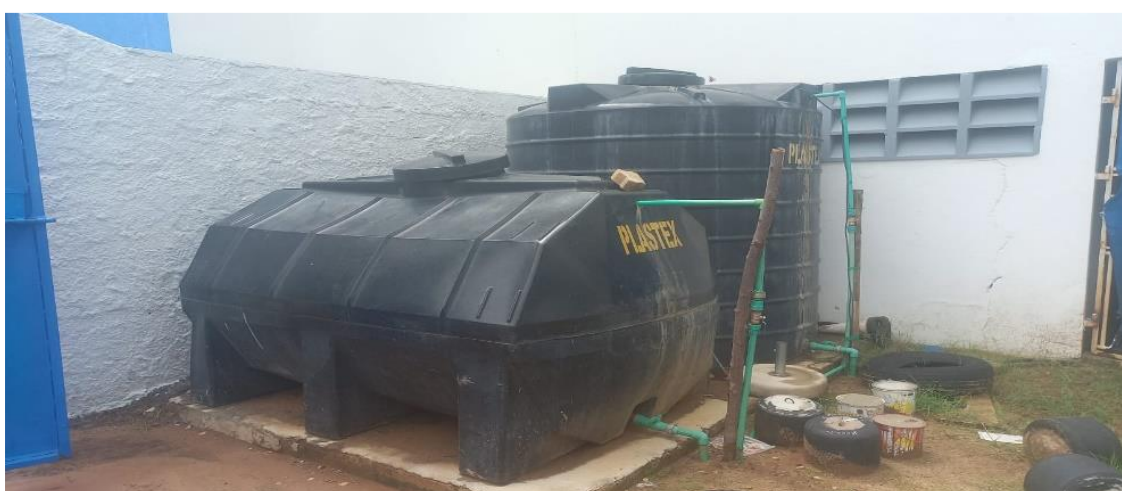
Tanques de água para o abastecimento das bancadas e boxes
